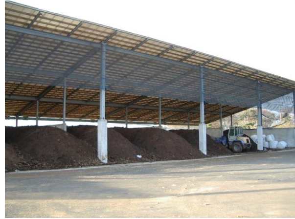
堆積型発酵槽
